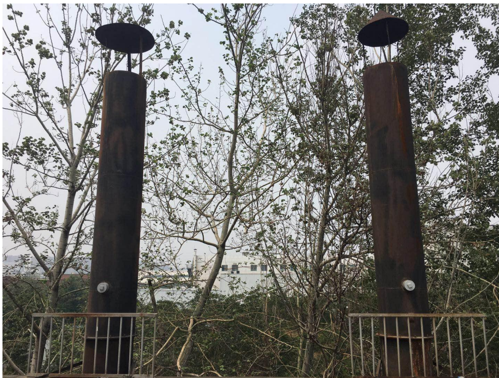
图 4-2 锅炉废气排口
